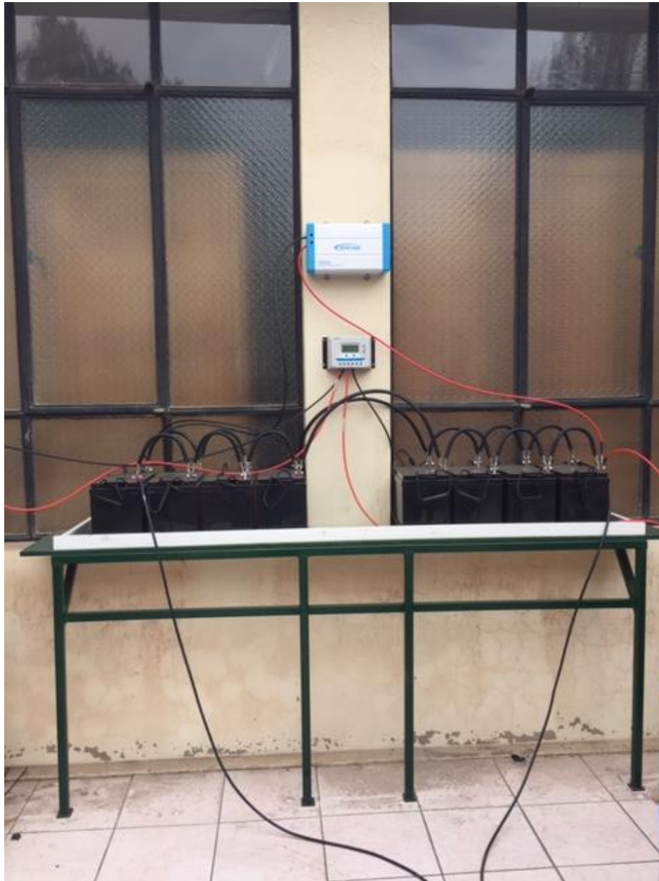
Figura 6.1: Fotografía del banco de baterías junto al controlador de carga y el inversor.
