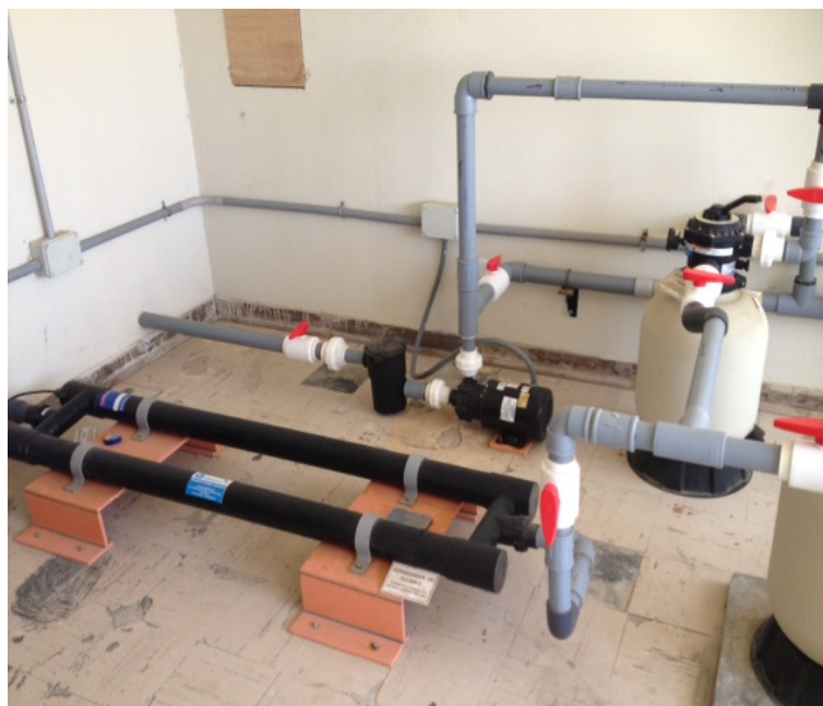
Sala de bombas y filtro de arena
