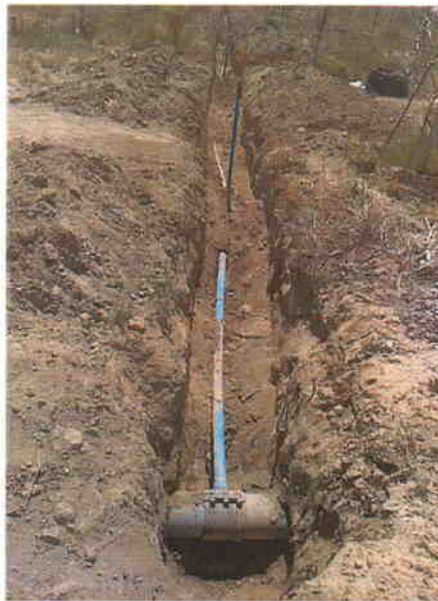
Figura 28. Fitting de PVC y válvulas programables instaladas en Mayorquina
